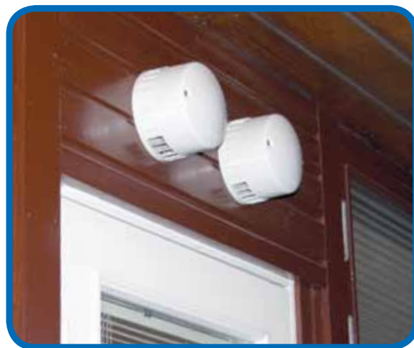
Kuvassa: Lossnayn ilmansyöttö- ja poistoputkien sääsuojat (näkyvä ulkoseinustalla)
